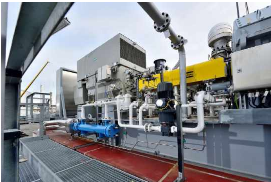
Stoomrecompressor Dow Terneuzen
